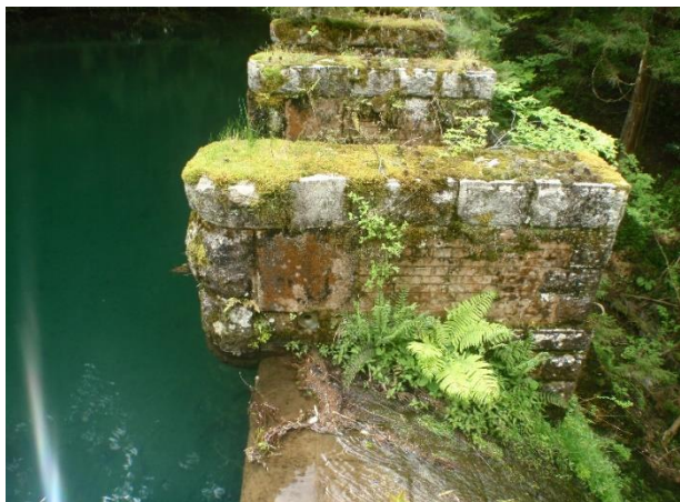
（放流路上部の構造＝元は開閉ゲートがあった）
