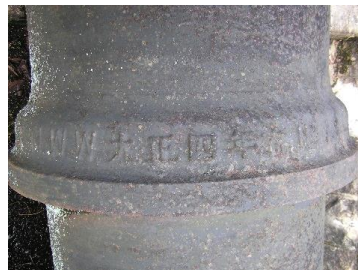
画像②ダムの配水管の継手の刻印
