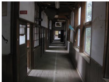
清掃後の校舎一階部分
