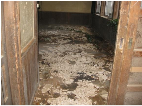
平屋(h17年度建築)の教室、天井ボードが落下
